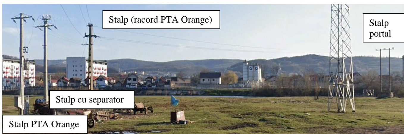
FOTO 3: Stalpii 20 kV nr. 2, 3, 5
