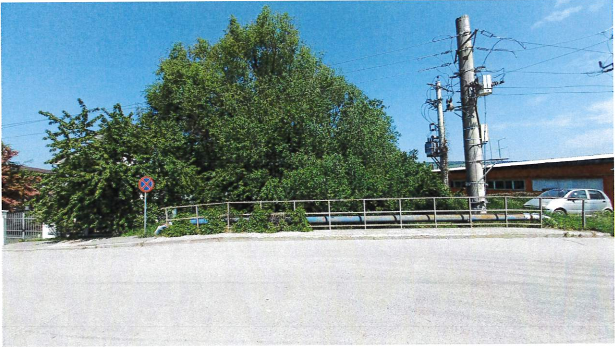
Pod pe strada Abatorului, cu albia plină de vegetație, care obturează curgerea apei
